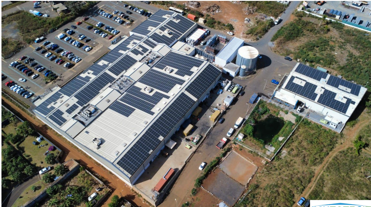
Installation de panneaux photovoltaïques en toiture exploités par Green Yellow
